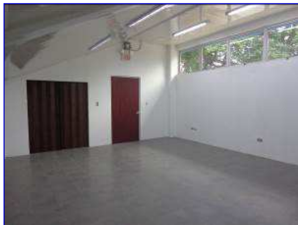
Vista interna de la sala de reuniones – Gradería Este, donde se observa la ejecución etapa de puertas, ventanas, lámparas, piso, cielo raso.
